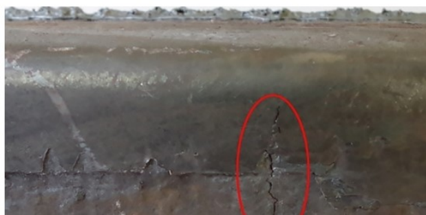
شکل ۶ ترک سطح اسلب فولاد بوردار.
