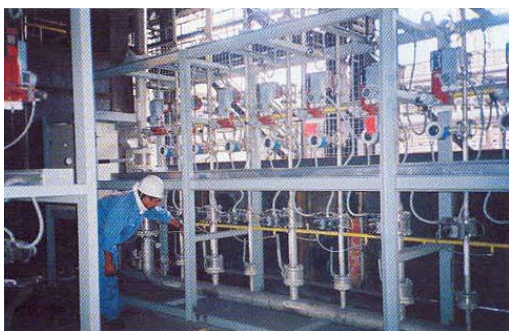
شکل 4. ایستگاه شیرهای اکسیژن.
