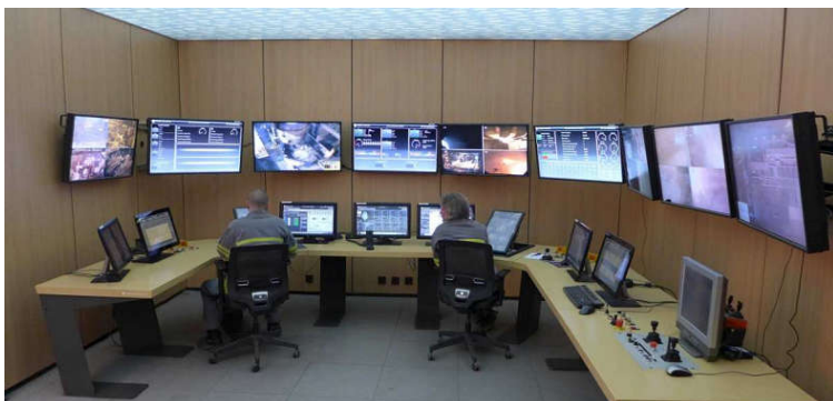
شکل 1: اتاق کنترل 3Q Automatic کارخانه فولادسازی Thy Marchinelle بلژیک.
